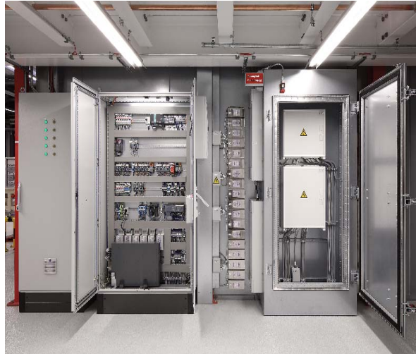
整套配电安装
